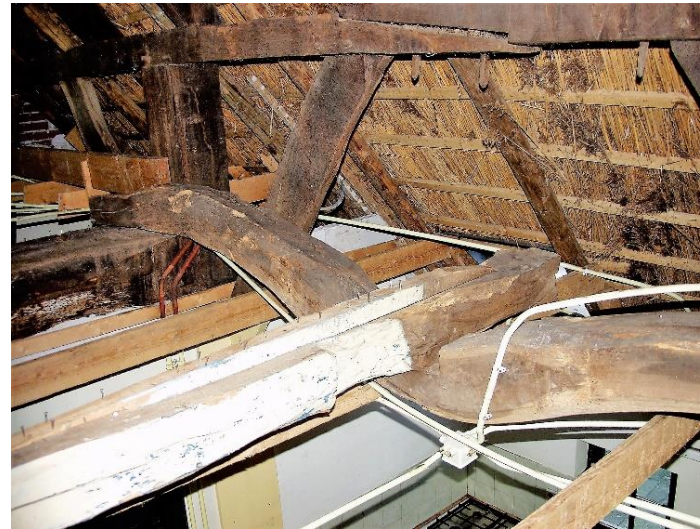
62 - 63. Een zeer uitzonderlijke oplegging van de tussenbalk op een ingebogen dwarsbalk. Het hout moet van nature deze vorm hebben gehad.
